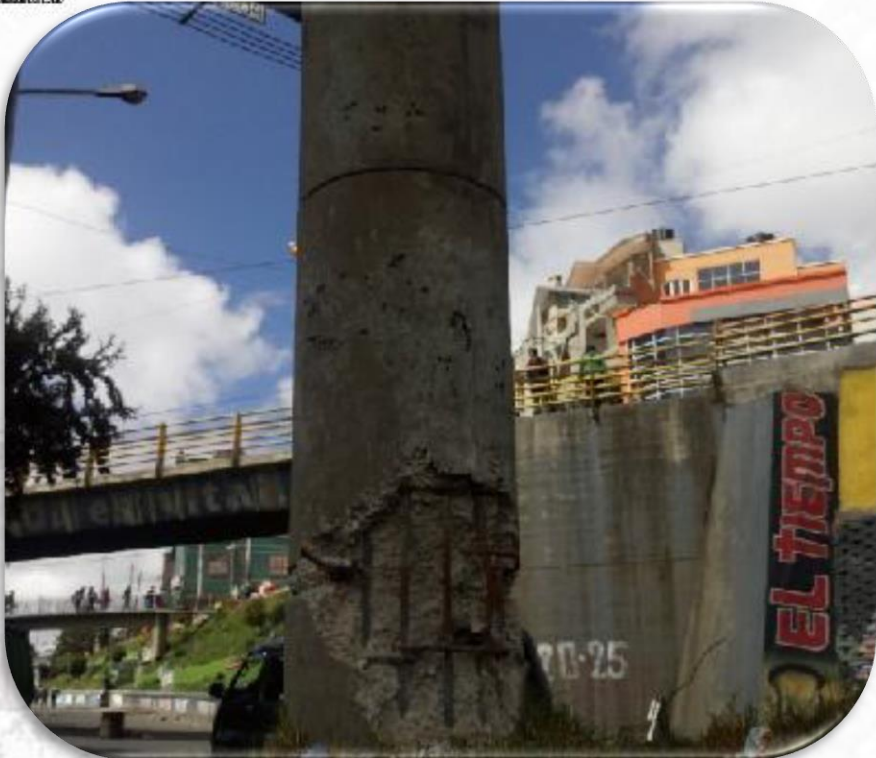
DAÑOS EN LA COLUMNA CENTRAL DE LA PASARELA CERCA DEL PEAJE SOBRE LA AUTOPISTA
