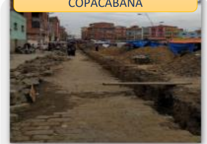
ALCANTARILLADO PLUVIAL C. COPACABANA
