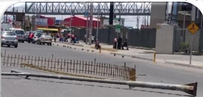
BORDILLO DE JARDINERA DAÑADO AV. 6 DE MARZO.
