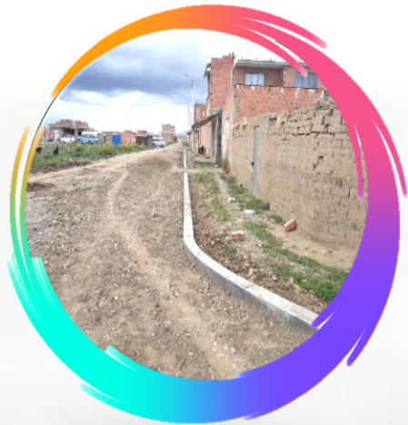
CORDONES DE ACERA
