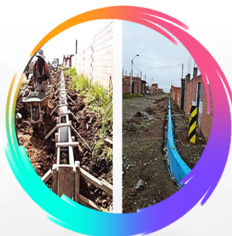
CORDONES DE ACERA
