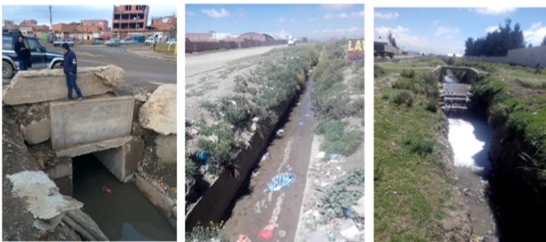
Figura 8. Estado Actual del Emisario Avenida Arica
